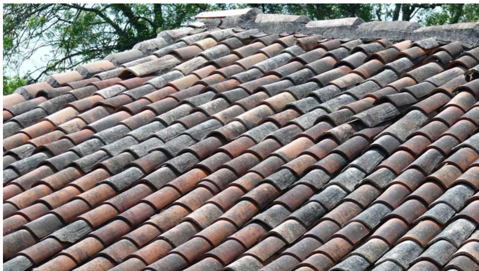
Tuiles rondes de tons mélangés
